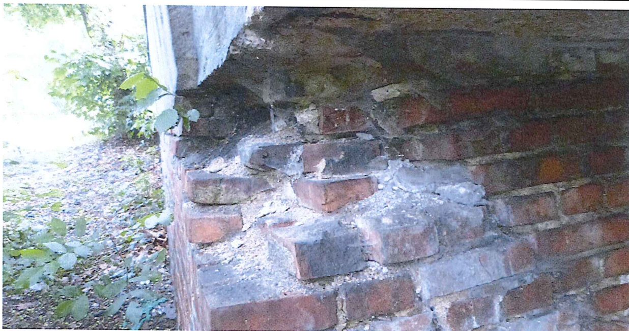
Fot. 11 Widok uszkodzeń podpory
