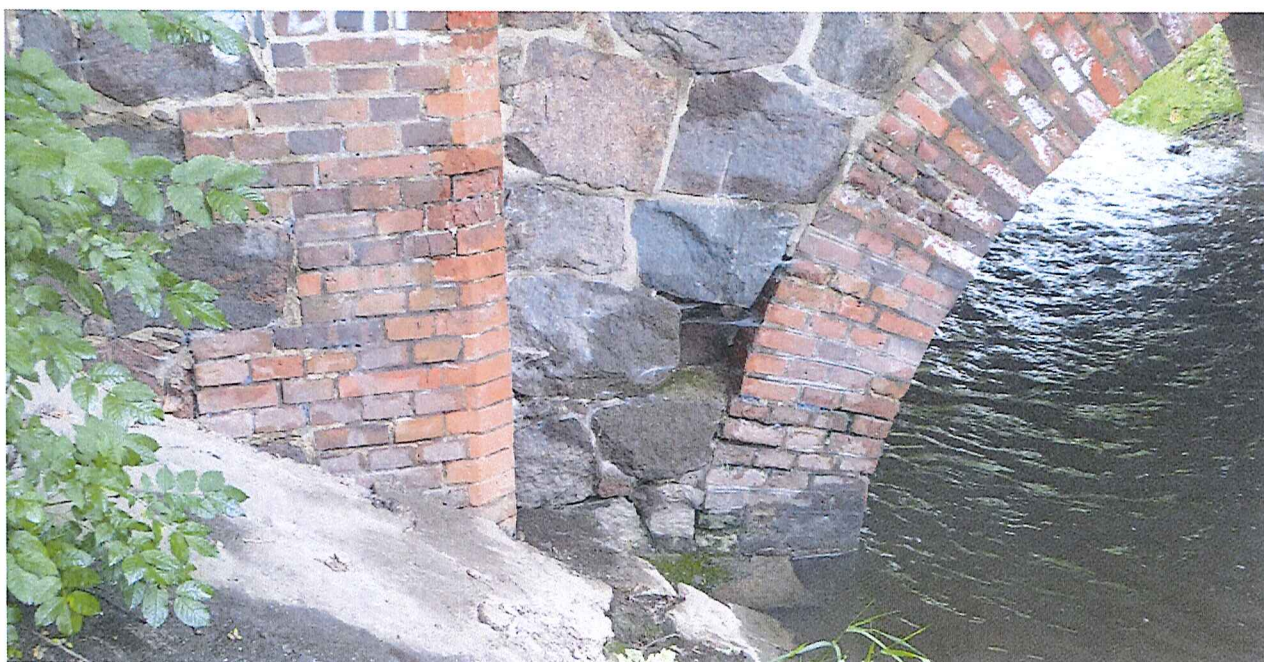
Fot. 7 Widok uszkodzeń podpory
