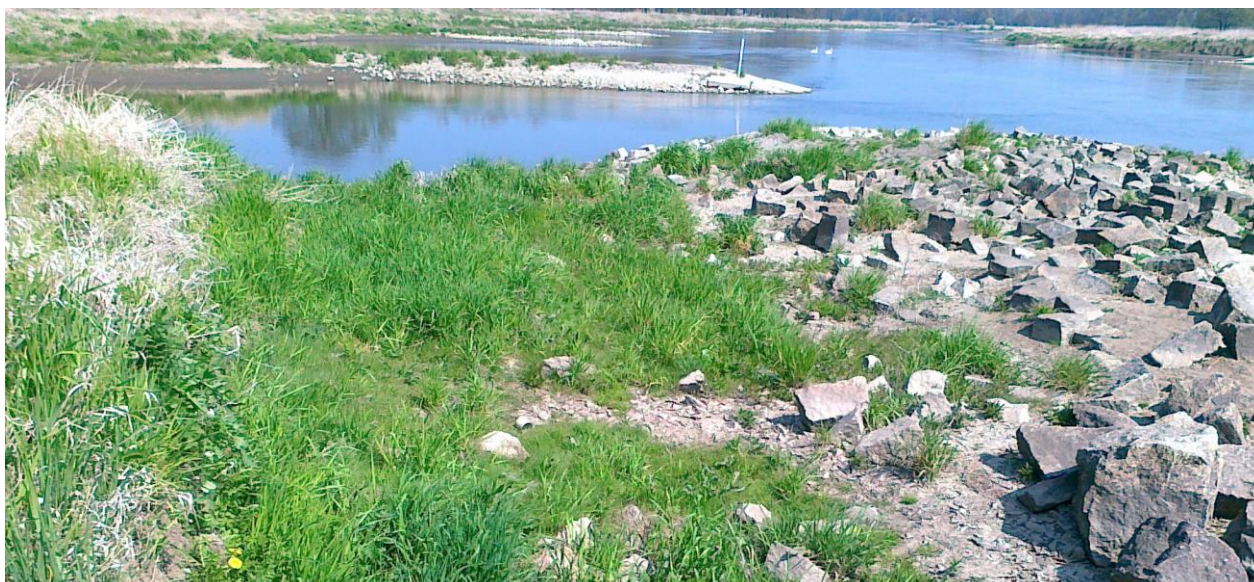
Fot 7. Akwen międzyostrogowy przeznaczony pod port jachtowy. Widoczny stan techniczny ostróg i stopień zamulenia.
